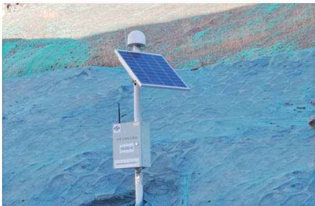
GNSS 自动监测设施
