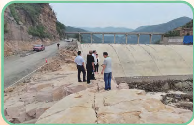
卫辉狮豹头水库损毁溢洪道查勘现场
