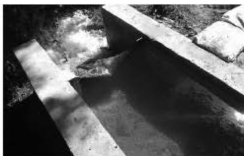
图2 灌浆前右岸山体渗漏严重,三角量水堰观测几乎满堰
