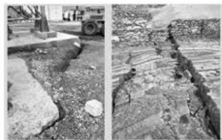
图 8 I 1 区后缘变形裂缝
