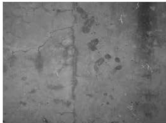
图3 前池闸墩裂缝
