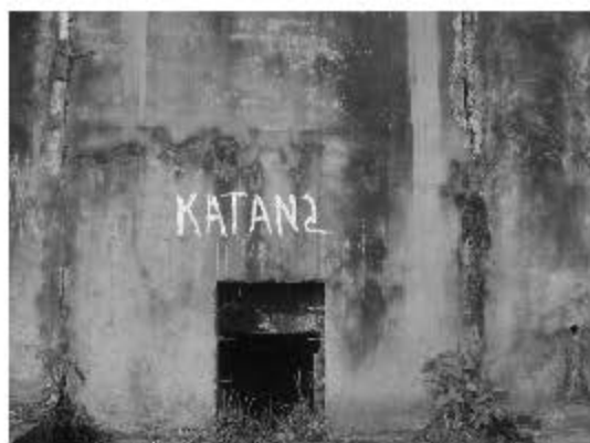
图4 退水闸裂缝分布,混凝土剥落
